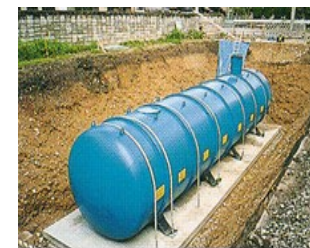
【耐震性貯水槽】
