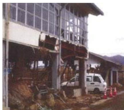
台風による体育施設の被害
