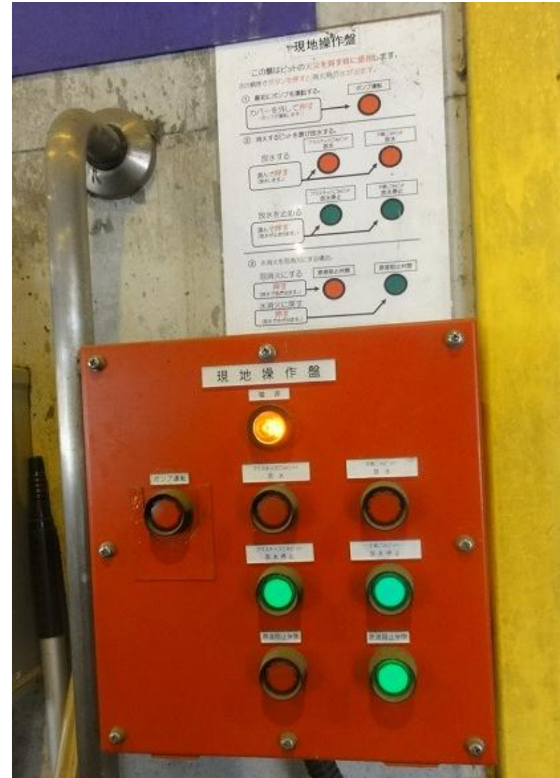
緊急用現場操作盤
