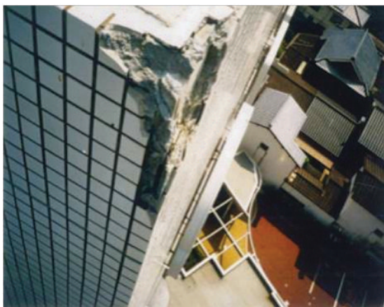
コンクリート外壁破損
