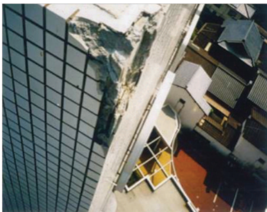
コンクリート外壁破損
